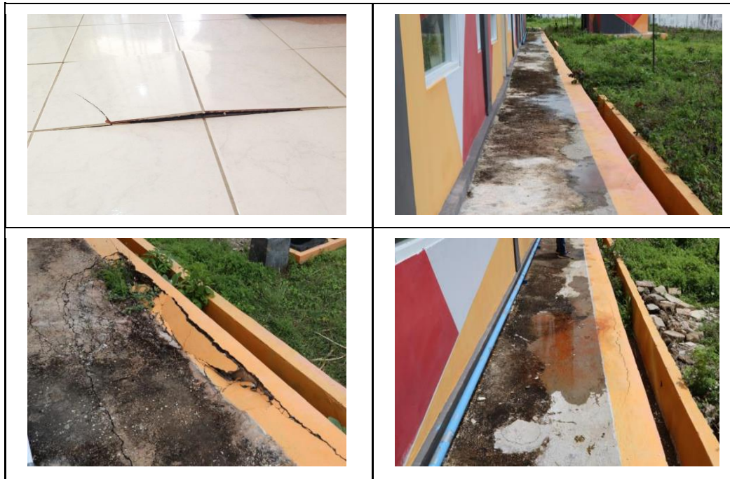
Gambar 4. 13 Foto Kerusakan Lantai
