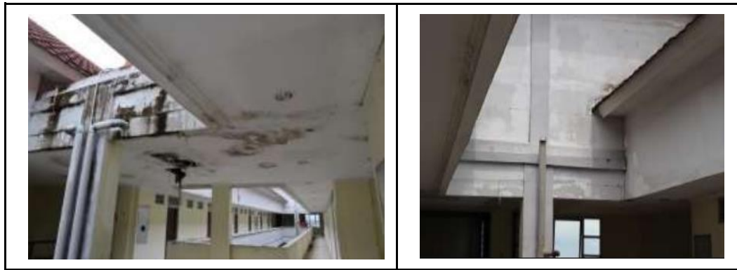
Gambar 4. 9 Kerusakan Langit – langit
