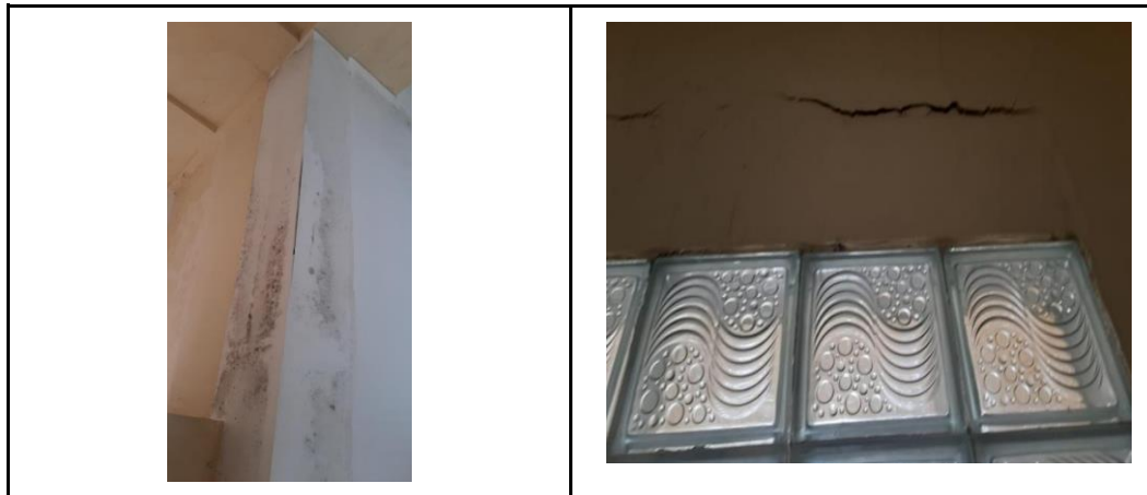
Gambar 4. 11 Foto Kerusakan Dinding
