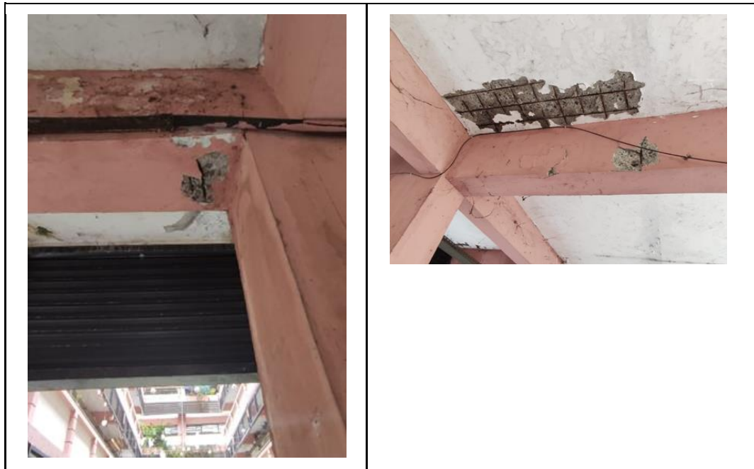
Gambar 4. 5 Foto Kerusakan Kolom, Balok, & Ring
