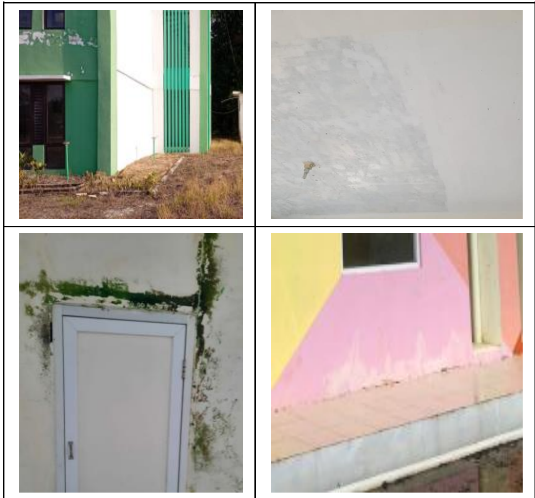
Gambar 4. 17 Foto Kerusakan Finishing
